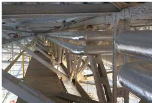
Instalacja ciepła wentylacyjnego w budynku Pijalni Główniej w Krynicy-Zdroju.
