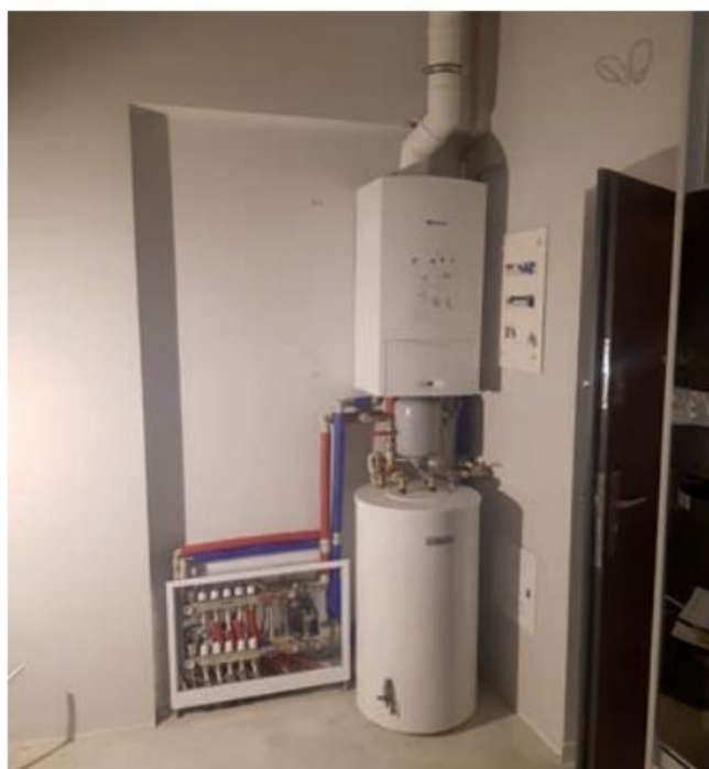
FOT. KOSUT INSTAL-MAX
