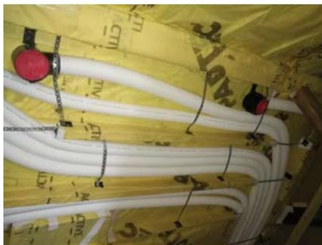
Rozprowadzenie kanałów wentylacyjnych
